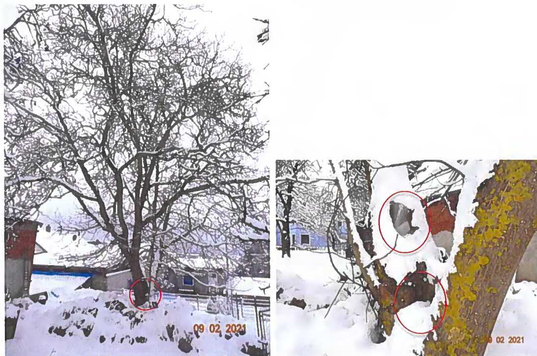
Abb. 6: Baum Nr. 11 – Faulhöhle am Stammgrund
